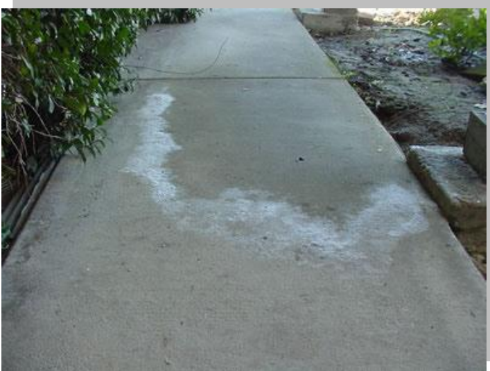
Rysunek 4. Wykwyty o białej barwie na powierzchni betonu [W1]
